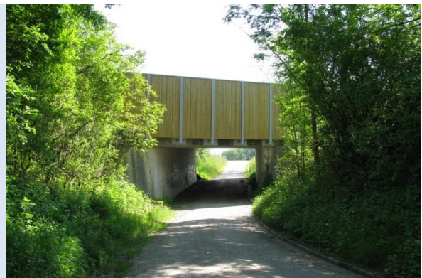
Seitlicher Blendschutz aus Holz, der es erlaubt einen Flugkorridor im Dunkeln zu halten
