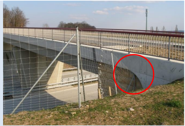
Negatives Beispiel : falscher Anschluss unter das Brückenbauwerk bewegt die Fledermäuse dazu, die Strasse zu überfliegen
