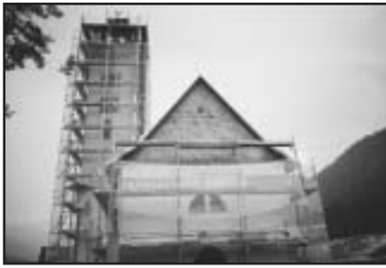
Als letztes wurde die Fassade beim dreieckigen Ausflugsloch (Bildmitte) neu verputzt. Das Fenster wurde auf der Innenseite aufgeraut, damit die Hufeisennasen beim «Ausflug» in gewohnter Weise nach vorne hangeln können.
