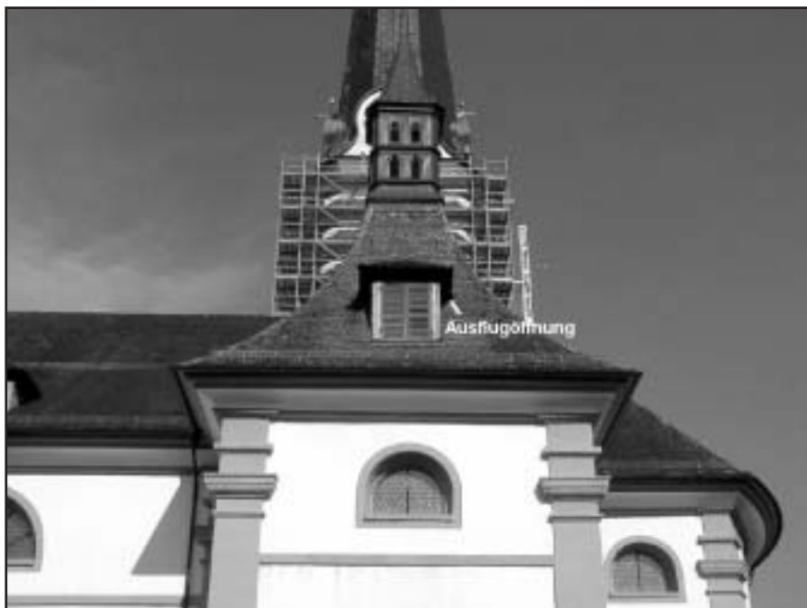
Die Ausflugöffnung der Grossen Mausohren in der Pfarrkirche in Malters wird nach der erfolgreichen Dachrenovation so rege benützt wie seit Jahrzehnten nicht mehr.
